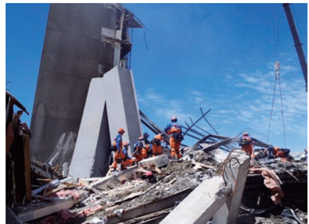
CTVビルにおける懸命の搜索活動 （平成23年2月ニュージーランド南島における大地震災害）
